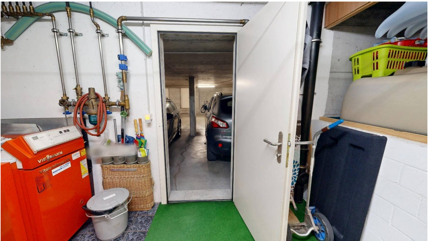
Waschküche/Technik-/Heizungsraum mit direktem Zugang in die Einstellhalle (UG)
